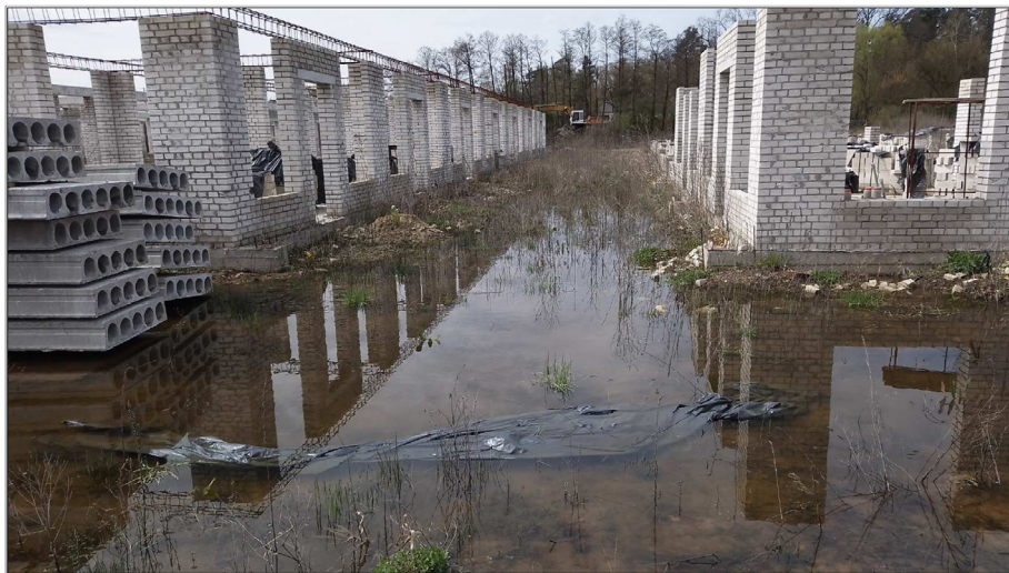
Рис. 3. Підтоплення ділянки заплави р. Ірпін в місці планової забудови нового Ірпінського центрального ринку поруч із залізничним мостом. Фото: Мичак Н. Г. 18.04.2023 р.
