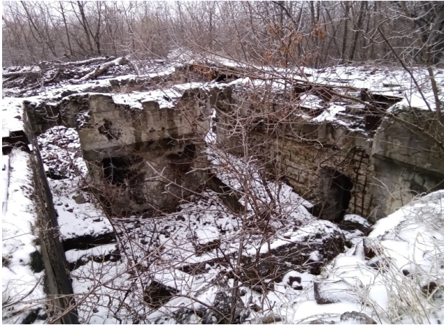
6-1. Підвальне приміщення будівлі підйомної машини The basement of the building lifting machine
